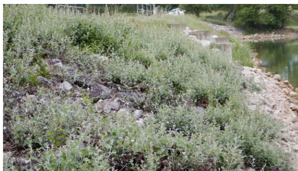
FIGURE 3. Drageons de peuplier blanc ayant colonisé l'ensemble du parement amont d'un barrage suite à l'abattage de l'arbre-mère.
