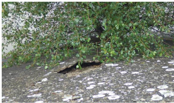
FIGURE 5. Dégradation par fissuration et soulèvement d'un parement en béton, lié au développement d'un peuplier noir
