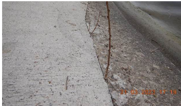
FIGURE 6. Nouvelles pousses (drageons) issues de la zone de réfection du parement en béton.
