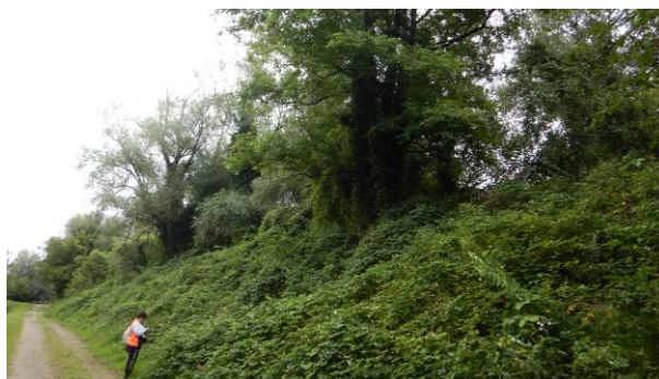
FIGURE 4. Tapis de ronce et clématite extrêmement dense ayant complètement colonisé le talus de digue et rendant impossible la surveillance visuelle de l'ouvrage.
