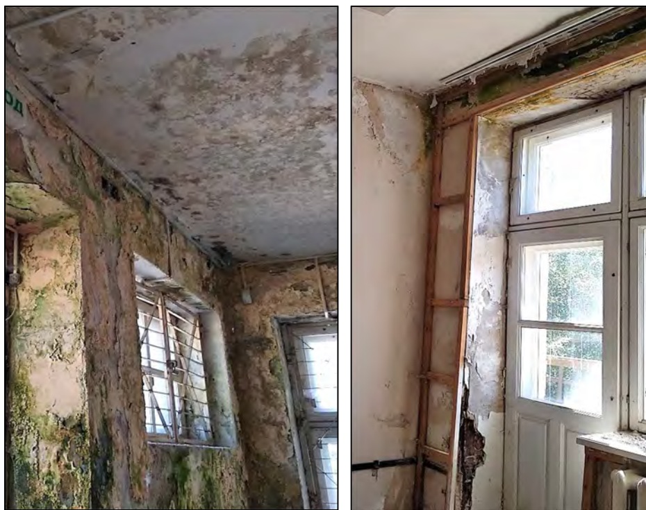
Рис. 3. Фрагменты помещений с признаками поражения биодеструкторами (III здание)
