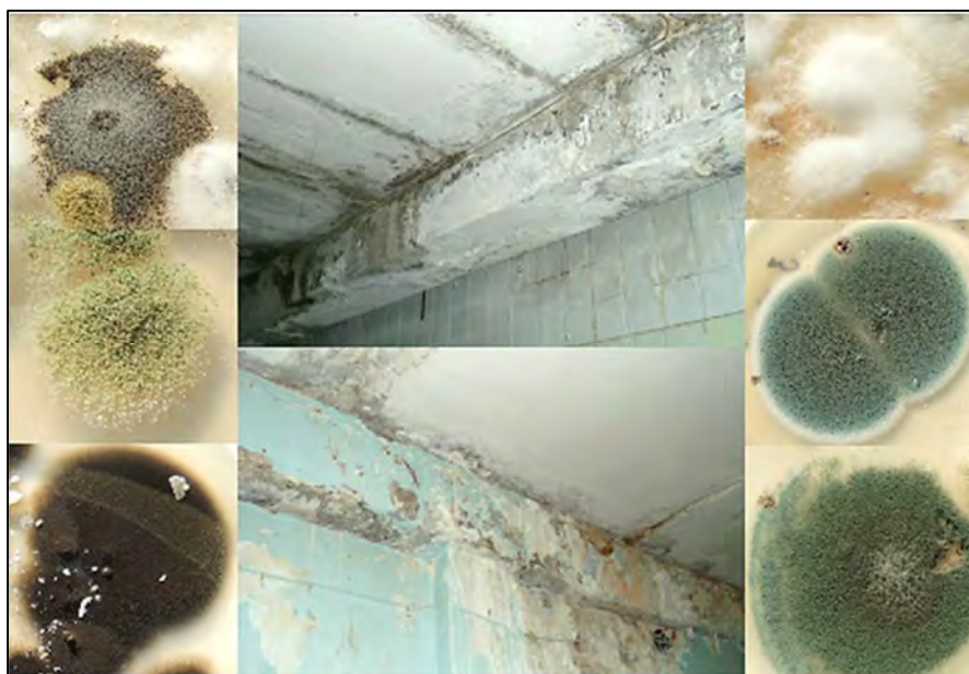
Рис. 1. Фрагменты помещений с признаками поражения грибами-деструкторами (I здание)
