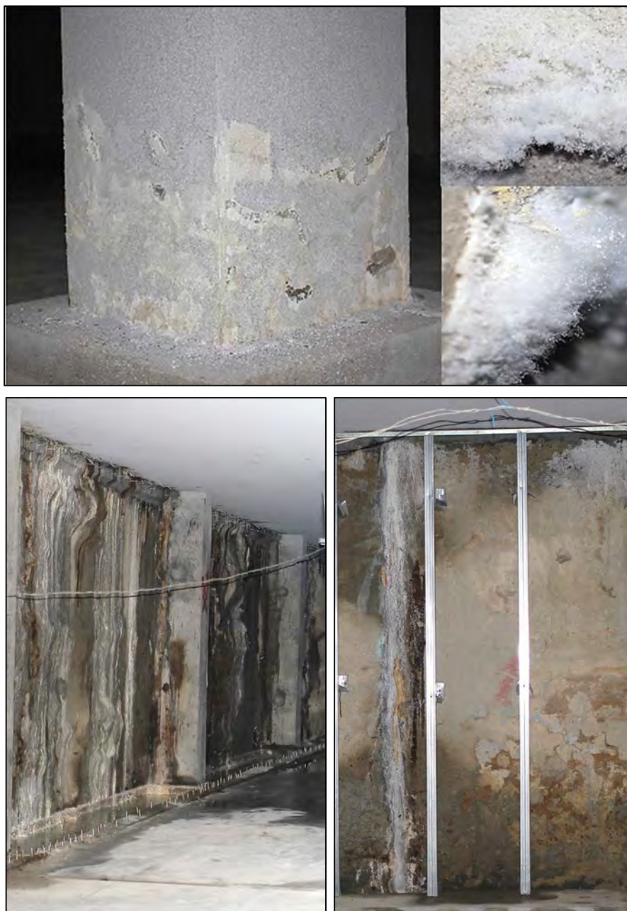
Рис. 2. Фрагменты помещений с признаками поражения биодеструкторами (II здание)
