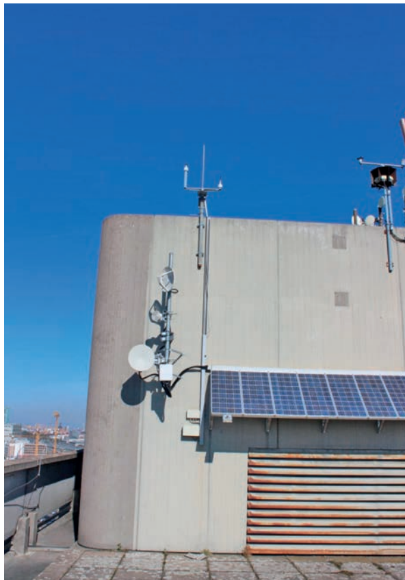
Abb. 8: Messstationen unterschiedlicher Standort- und Messqualitäten – Beispiel Hochschule Mannheim, Fakultät für Elektrotechnik
