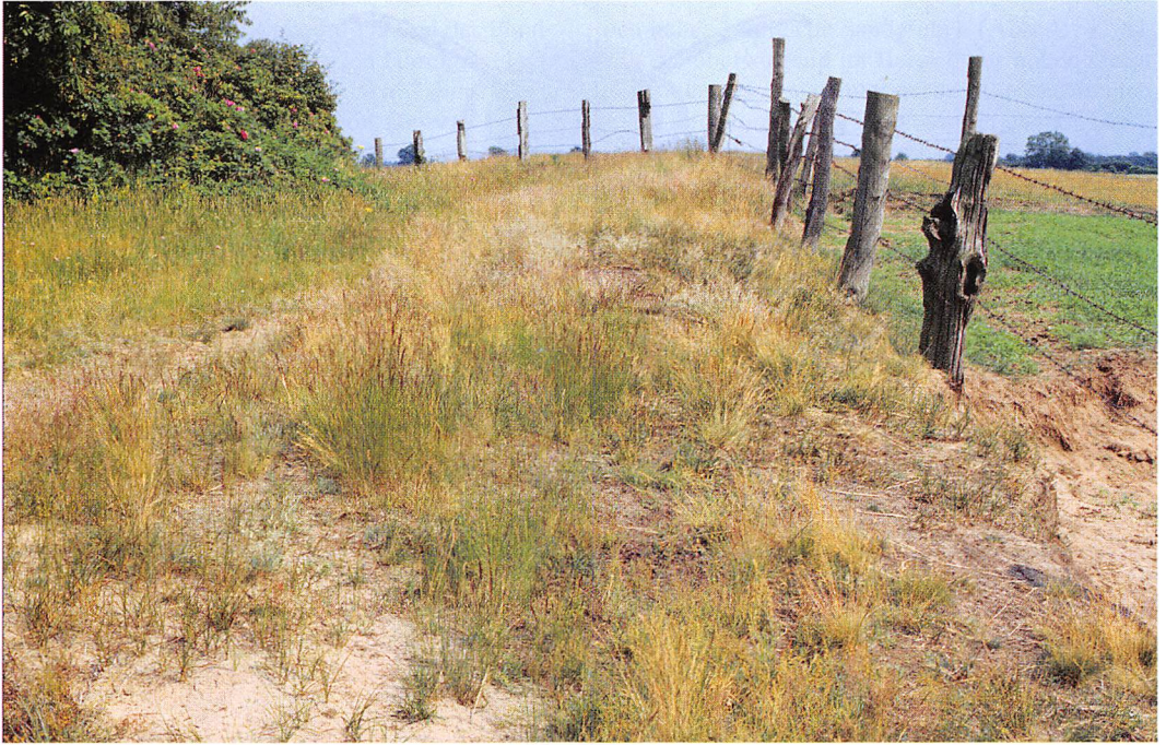
Abb. 47: Eichenzaunpfähle am Weserdeich bei Achim-Bierden. Das Vorkommen vieler Bienen- und Wespenarten hängt hier vom Vorhandensein solcher Totholzstrukturen ab (Foto: H. Riemann).
