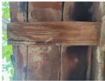
(d) Insect infestation of eave rafters
