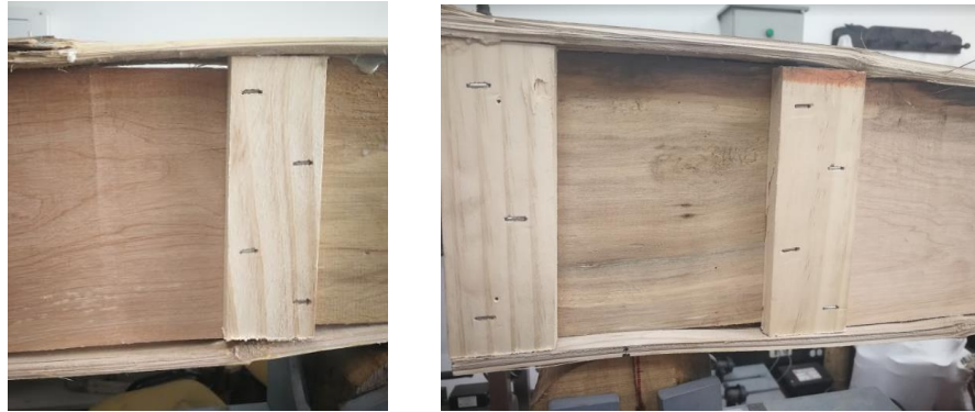
Figura 108. Desplazamiento relativo entre piezas adyacentes.
