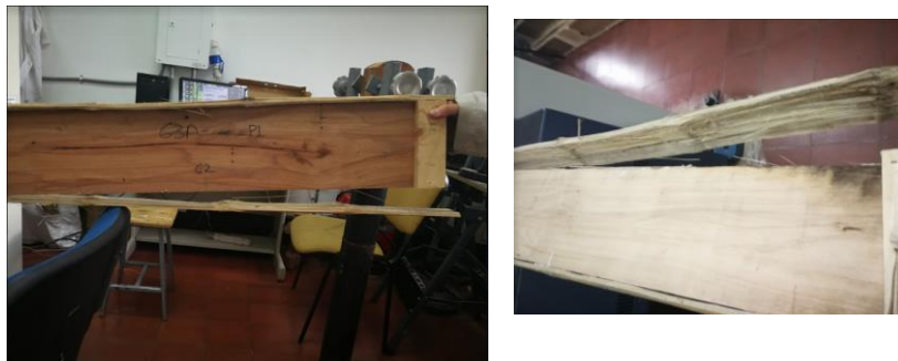
Figura 106. Falla en la línea de cola en los extremos de las vigas.
